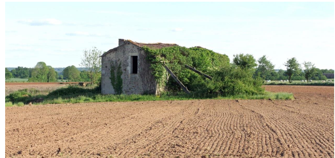
Photo 41 : bâtiment en ruine de la Naulerie
